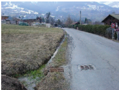
Photo 10 : Réseau EP de la route de Barthoud
