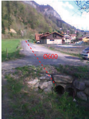
Photo 4 : Réseau EP les Ilettes
